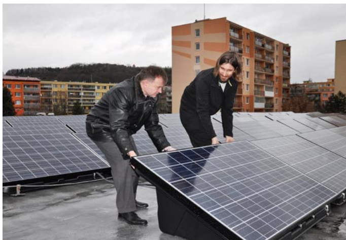
Místostarosta Krejza s energetickým manažerem Klusákem kontrolují stav panelů na střeše Havlíčkovy školy. Foto Eva Břeňová
