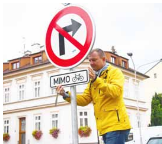
Místostarosta Lukas Wunsch při instalaci značení v ulici Palachova. Foto: Michaela Bubeníčková
